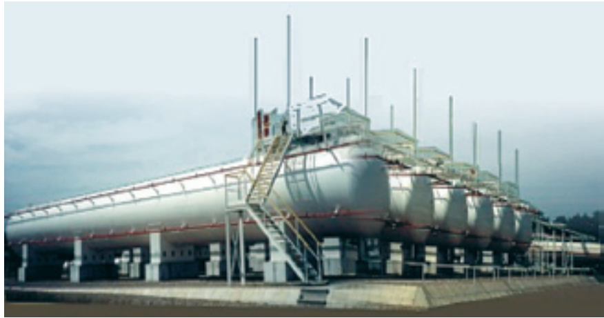
Fot. 1. Zbiorniki do magazynowania LPG ( http://zasta.com.pl/lpg.htm )
