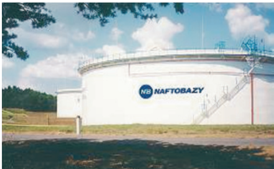
Fot. 2. Zbiorniki do magazynowania ciekłych węglowodorów ( http://www.geoland.pl/dodatki/energia_XVIII/artkuł_52.html )
